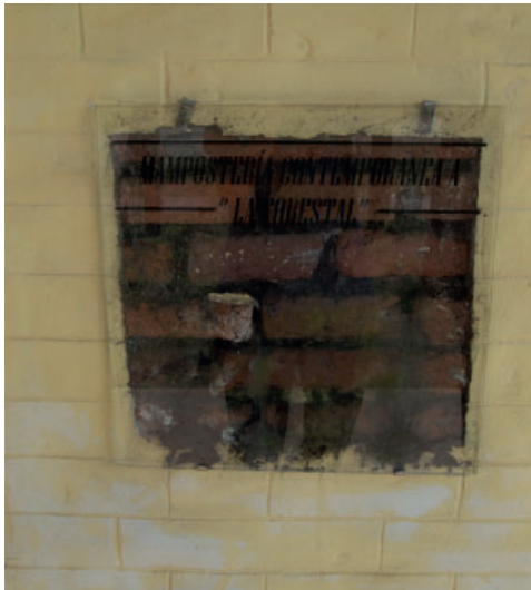
Figura 19. Este caso ejemplifica una intervención inadecuada, donde la humedad por condensación genera un proceso de degradación en el mortero de tierra.
