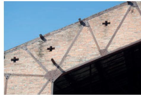
Figura 6b. Detalle de cercha estructural conformada por perfiles macizos I (IPN) vinculados mediante roblonado (remache) donde el cerramiento se realiza con ladrillos macizos comunes asentados en mezcla y adaptados al formato de los espacios vacíos.
