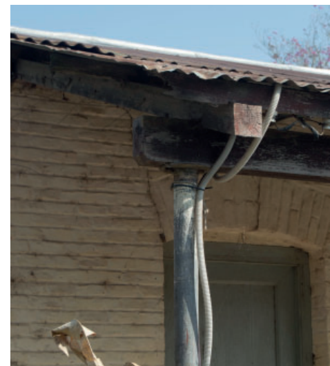
Figura 15. Instalaciones sanitarias en condiciones inadecuadas
