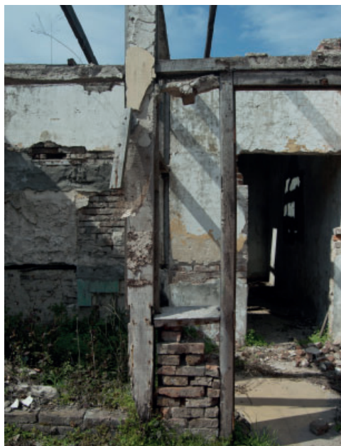
Figura 4a. Vestigios de construcción conformado por una estructura de madera y cerramiento con ladrillo macisos. Ubicada frente a la plaza San Martín y junto a la Escuela Jose Estrada, Tartagal.
