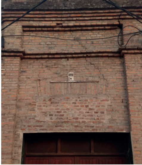
Figura 18. Cambio de abertura y patologías -grietas- asociadas a deficiencias creadas en el dintel
