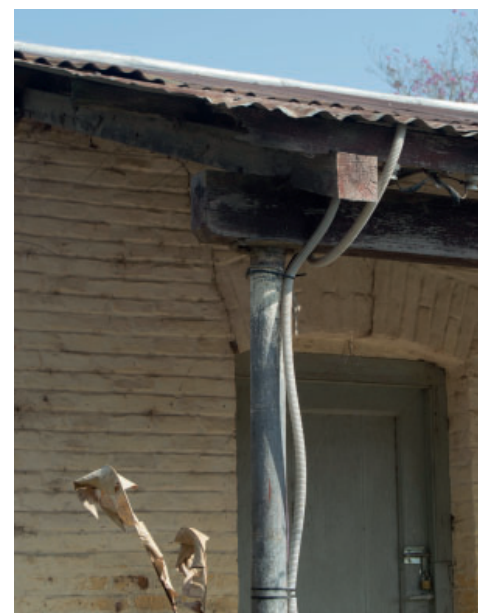
Figura 17. Instalación eléctrica en condiciones inadecuadas
