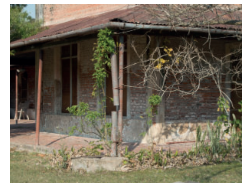
Figura 13. Ejemplo de desajuste recurrente en muchas construcciones de los pueblos relevados. Se observa el desprendimiento de canaletas, falta de pendiente, discontinuidades, entre otras fallencias del sistema de descarga pluvial.
